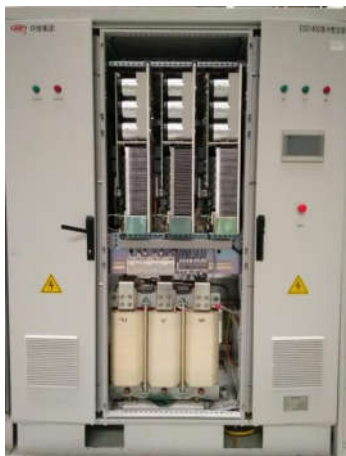
图 9 ESS1400 集中整流器 Fig. 9 Centralized rectifier of ESS1400
